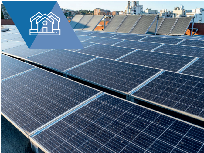
Plaques solars de l'Escola Municipal de Treball
